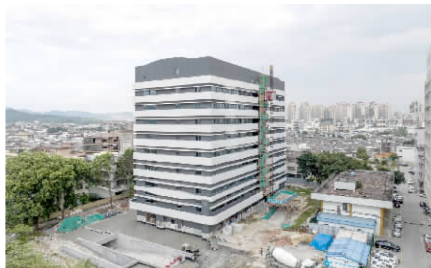
→揭东区人民医院传染科楼项目正全力加快施工进度。 郑楚藩 摄
