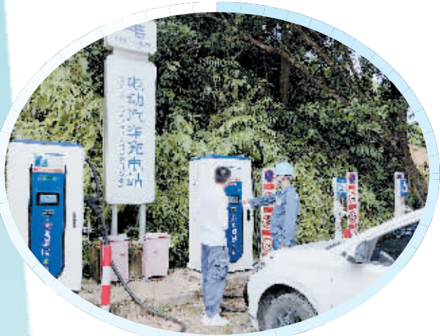
揭西供电局运维人员对充电桩站点进行检查维护。
