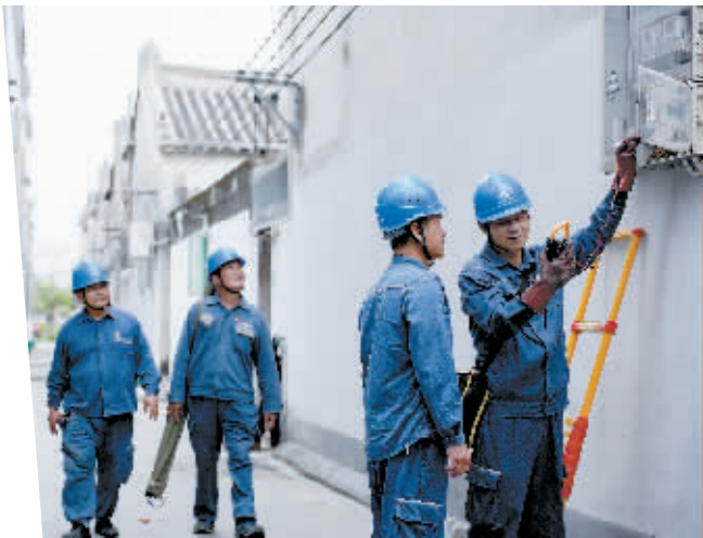
揭西供电局棉湖供电所党员服务队到鲤鱼沟村对线路设备进行巡视、检查、维护。
