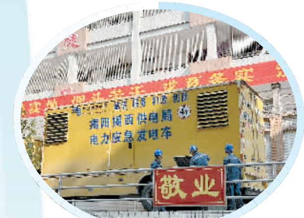
揭西供电局电力应急发电车开进校园。
